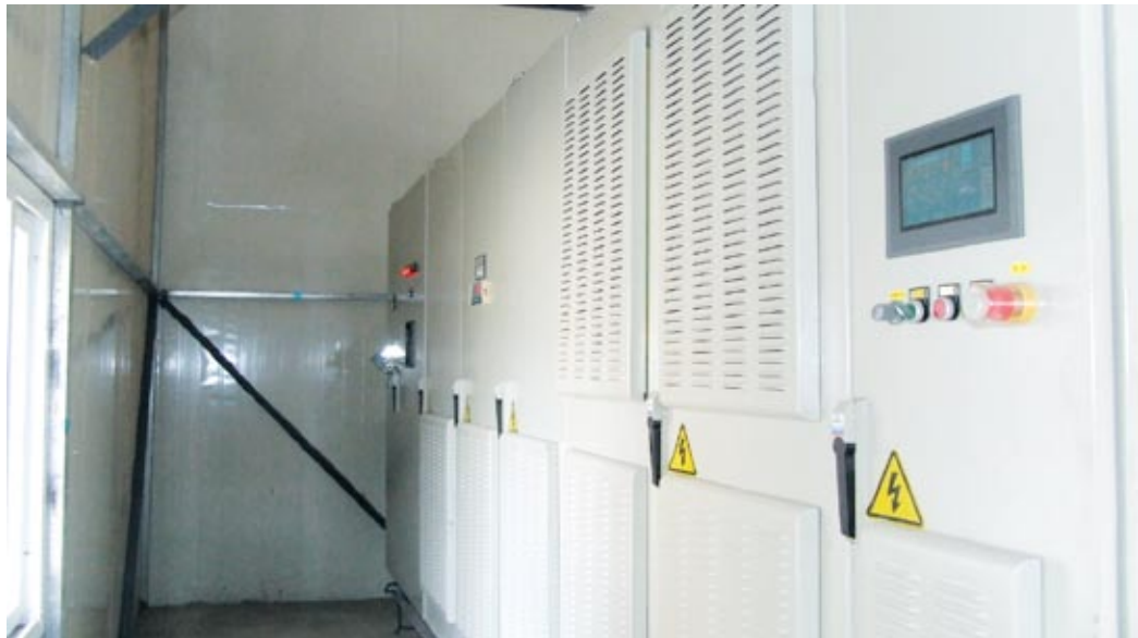
图 4 高压变频器现场照片
