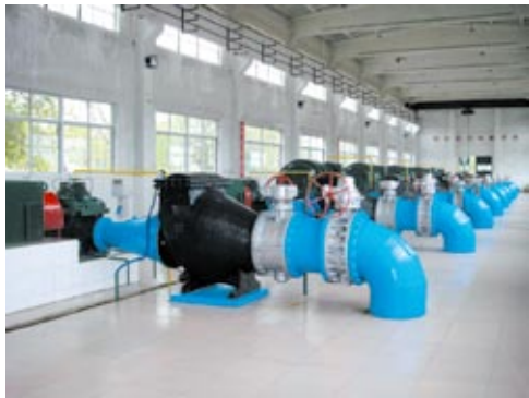
图 1 设备现场情况图
