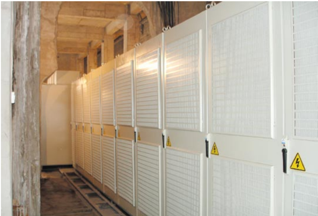
图 3 高压变频器现场运行照片
